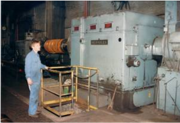
Die Maschine hat ein Spindeltrieb mit 220 KW. Die ganze Elektrik wurde von uns erneuert inkl. des Spindeltriebs. WU4415
