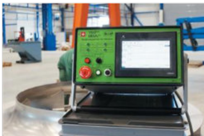
Photo N° 25 Tableau de commande WIAP-MEMV 20E à Tampere Finlande (Août 2017 JW).
