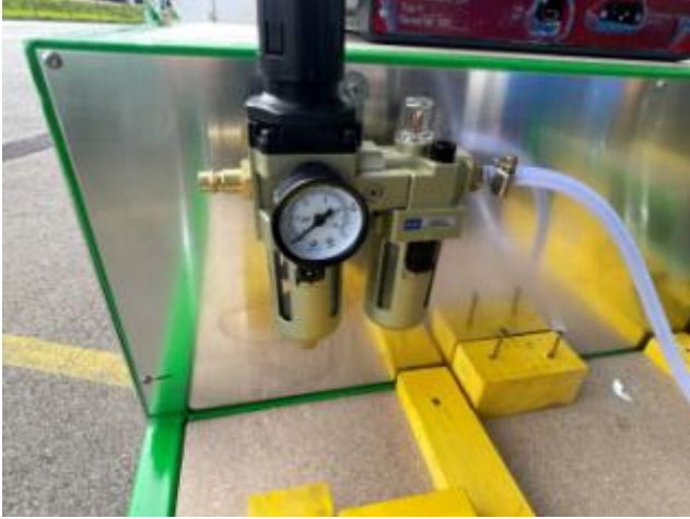
Bild 8.1 Die Lufteinspeisung wird mit gewarteter Luft versorgt
