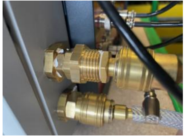
Bild 8.2 Am Steuergerät ist ein Luftanschluss für die gewartete Luft und der Ausgang an die Drehvorrichtung
