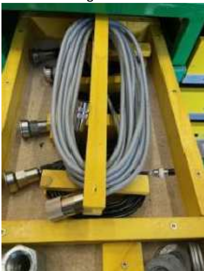
Bild 7.7 Anschlusskabel bei den Sonden abgelegt
