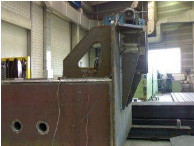
Фото 9: Напруження у кранових конструкціях знімаються вібрацією.
