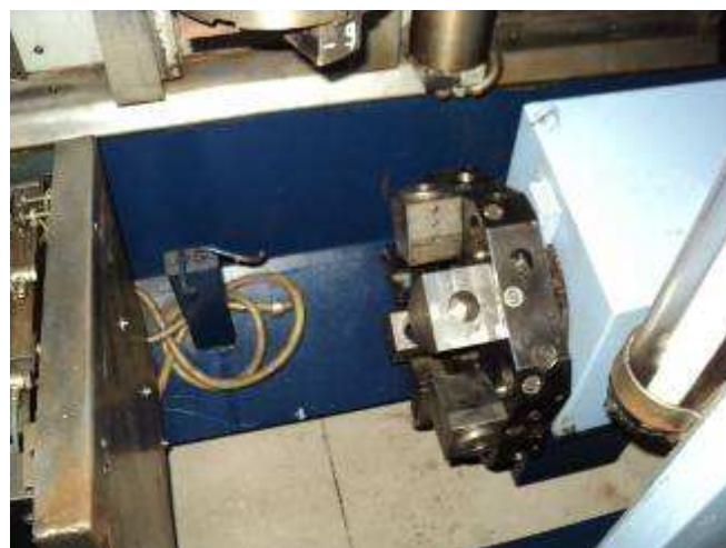
Foto 24. Der Sauter Revolver im Maschinenraum.
