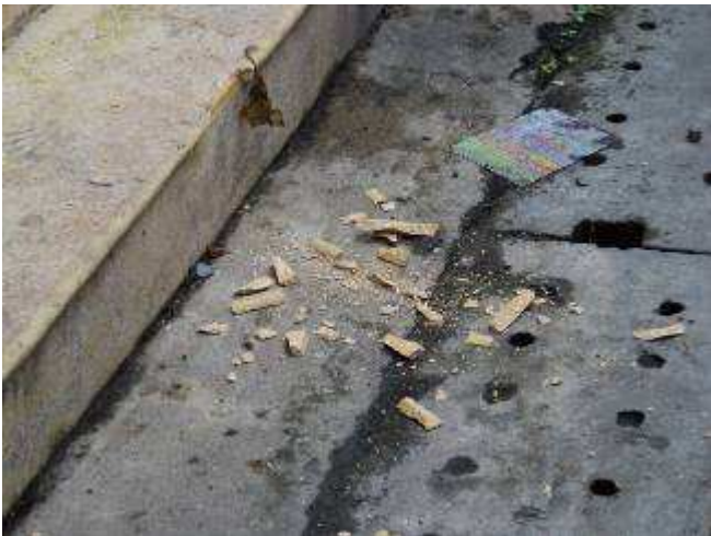
Foto 12 .... und hopp die Treppe ist beschädigt.
