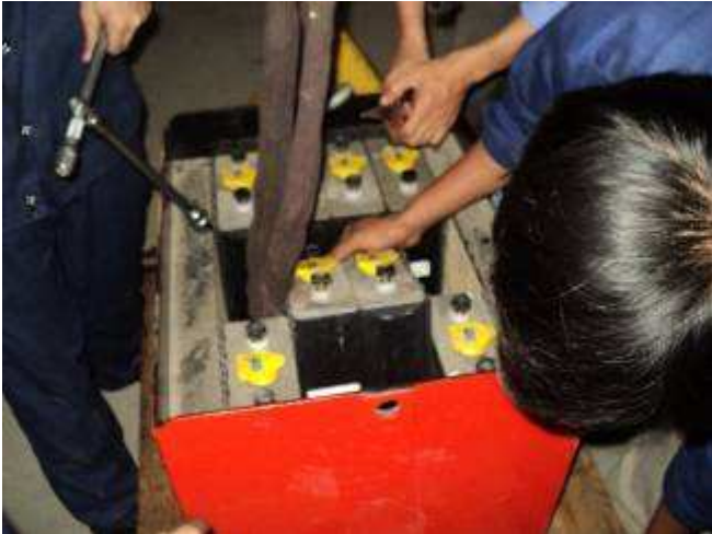
Photo 28: Nach Rückfrage bei Steinbock (dem Staplerhersteller) ob diese repariert werden kann, kam ein „nein“. Notfalls könne man eine LKW Batterie nehmen. Die hätte uns 400 Franken gekostet 200 Amp. 2 x 12 Volt / 24 Volt. Doch unser Koordinator Hieu sagte, viel billiger ist reparieren, darum bauen wir sie aus.
