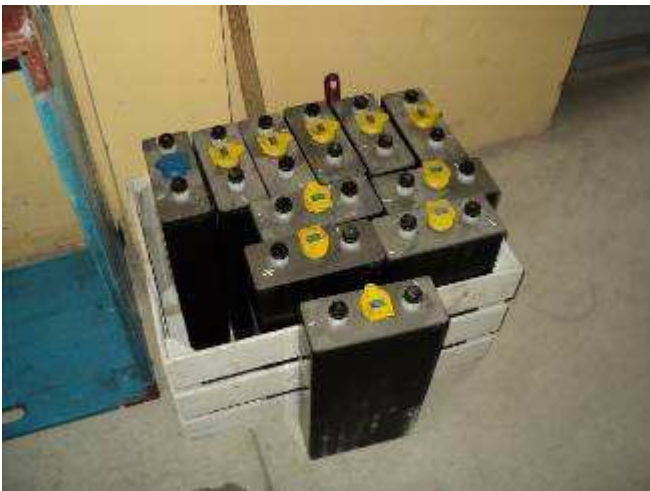
Photo 29: Hier sind die Batterien bereit, um in die Reparatur gebracht zu werden. Für die Fracht müssen wir 5 Franken zahlen, es kommt einer mit einem Lasten-Mofa. Jede Batterie ist 18 kg, das spezifische Gewicht ist somit bei dieser Batterie 3,3 kg. Es sind 12 Stück.
